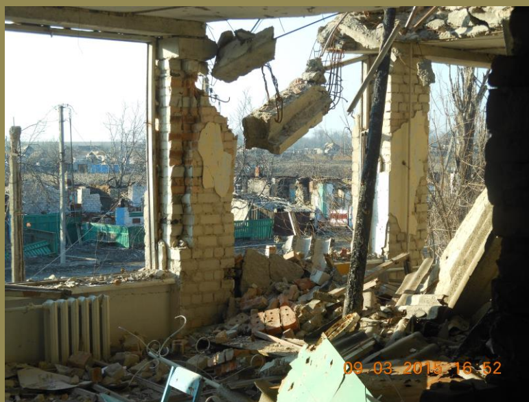
Разрушенные классы Никишанской школы
