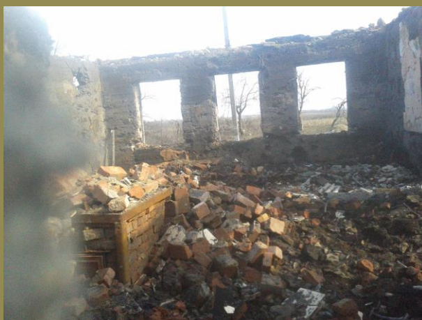
Руины жилого дома
